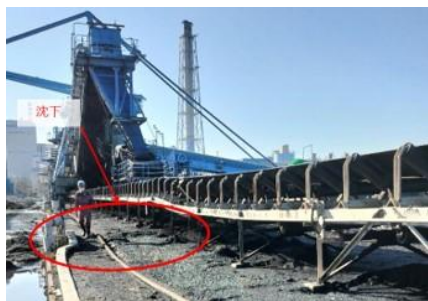
積付払出機の走行レール沈下
