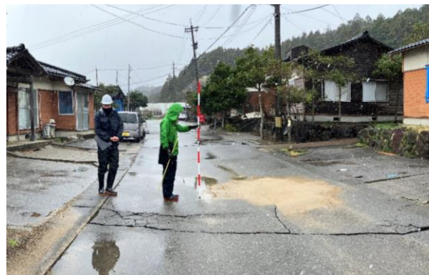
液状化の状況（断層中央部付近）
