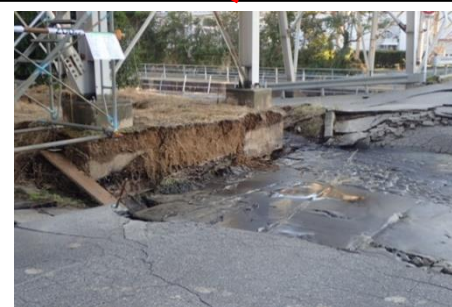
構内道路の陥没・亀裂
