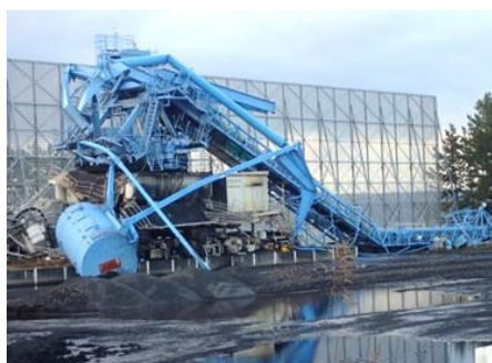
払出機の倒壊
