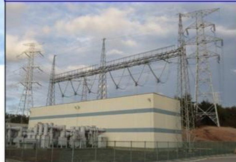
■ 志賀原子力線（275kV）
