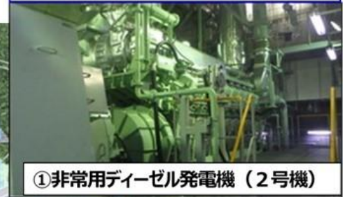
■ バックアップ電源（一部のみ掲載）
